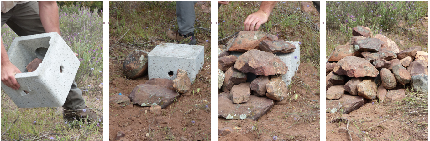
Variante de l'abri type "Cairn" développée pour le Lézard ocellé s'organise autour d'un regard en béton et permet de pallier au manque de grosses pierres sur le site. ©J. VIDAL, CEN PACA
